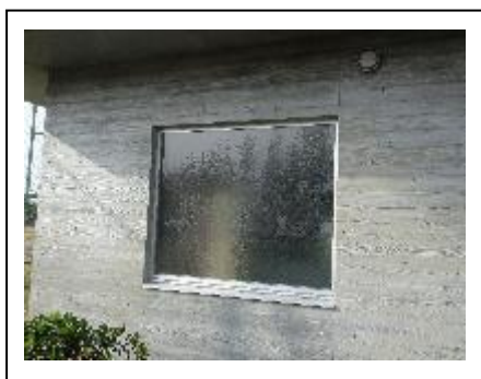
【野球場トイレ窓ガラス破損修繕】
