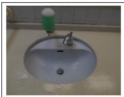
【自動水栓の手洗い場】
