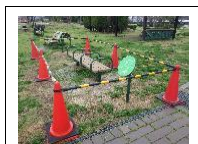
【健康遊具支柱地際腐食修繕】
